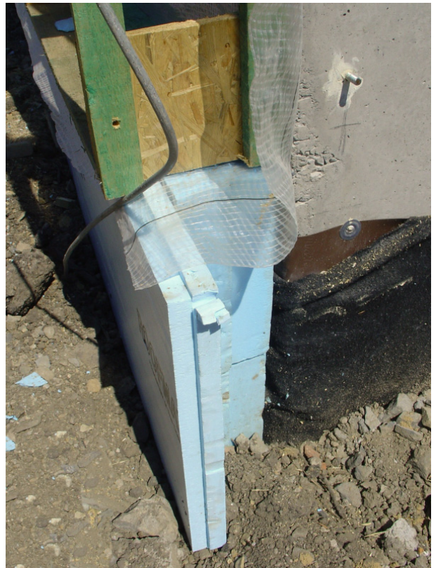
Obr. 4 Extrudovaný polystyren se používá především tam, kde dochází ke kontaktu tepelné izolace se zemí. Na obrázku je použití při izolaci soklu seminárního centra v Hostětíně. Pro izolaci vrchní betonové stěny byla použita minerální vlna vkládaná mezi lepené I-profilů.
