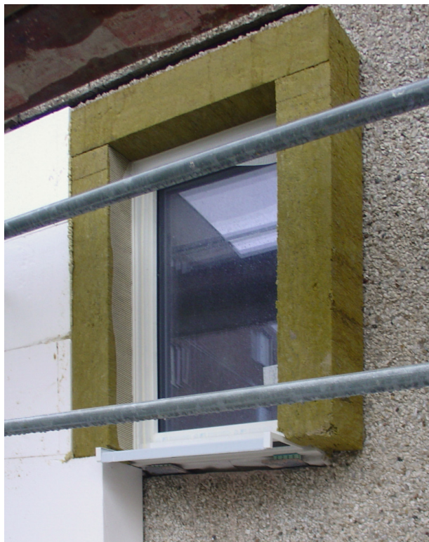
Obr. 5 Výhodou izolace z minerálních vláken je její nehořlavost. Zde při sanaci mateřské školy v Drážďanech na úrovni pasivního standardu bylo vytvořeno nehořlavé ostění okna. Minerální vlna se často používá v kombinaci s polystyrenem.
