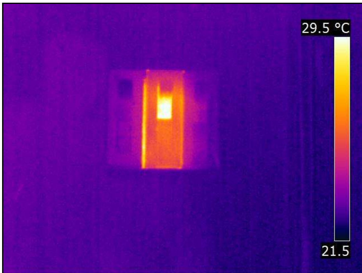
Obr. Termovizní snímek hlavního domovního jističe
