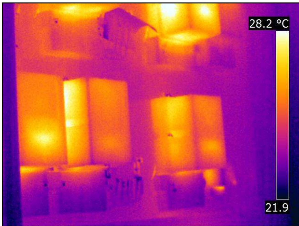
Obr. Termovizní snímek rozvaděče s elektroměry
