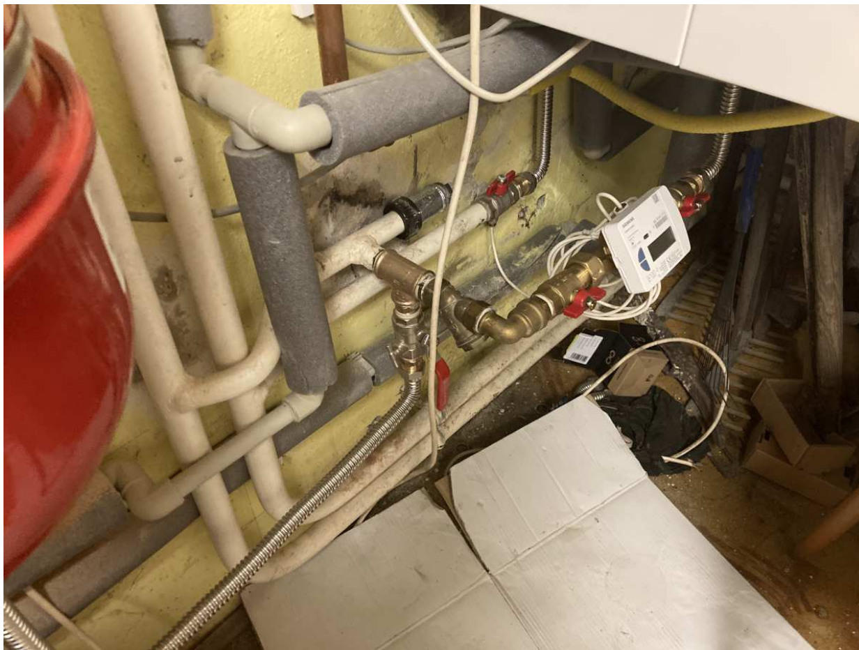
obrázek 2 – pohled na kalorimetr plynového kotle
