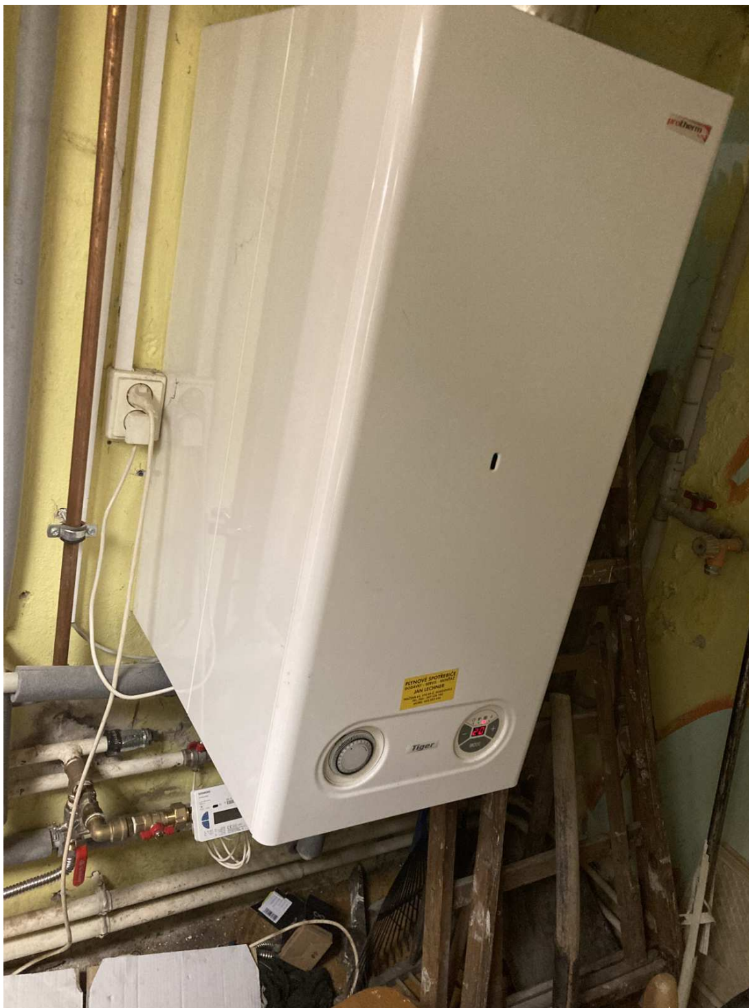
obrázek 1 – pohled na plynový kotel
