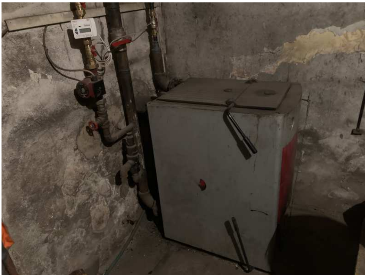
Obrázek 7 – pohled na kalorimetr instalovaný na kotli na uhlí
