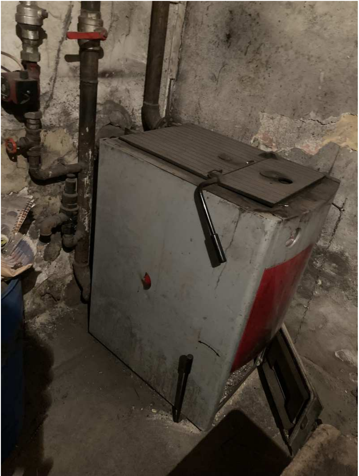
Obrázek 5 – pohled na kotel na uhlí
