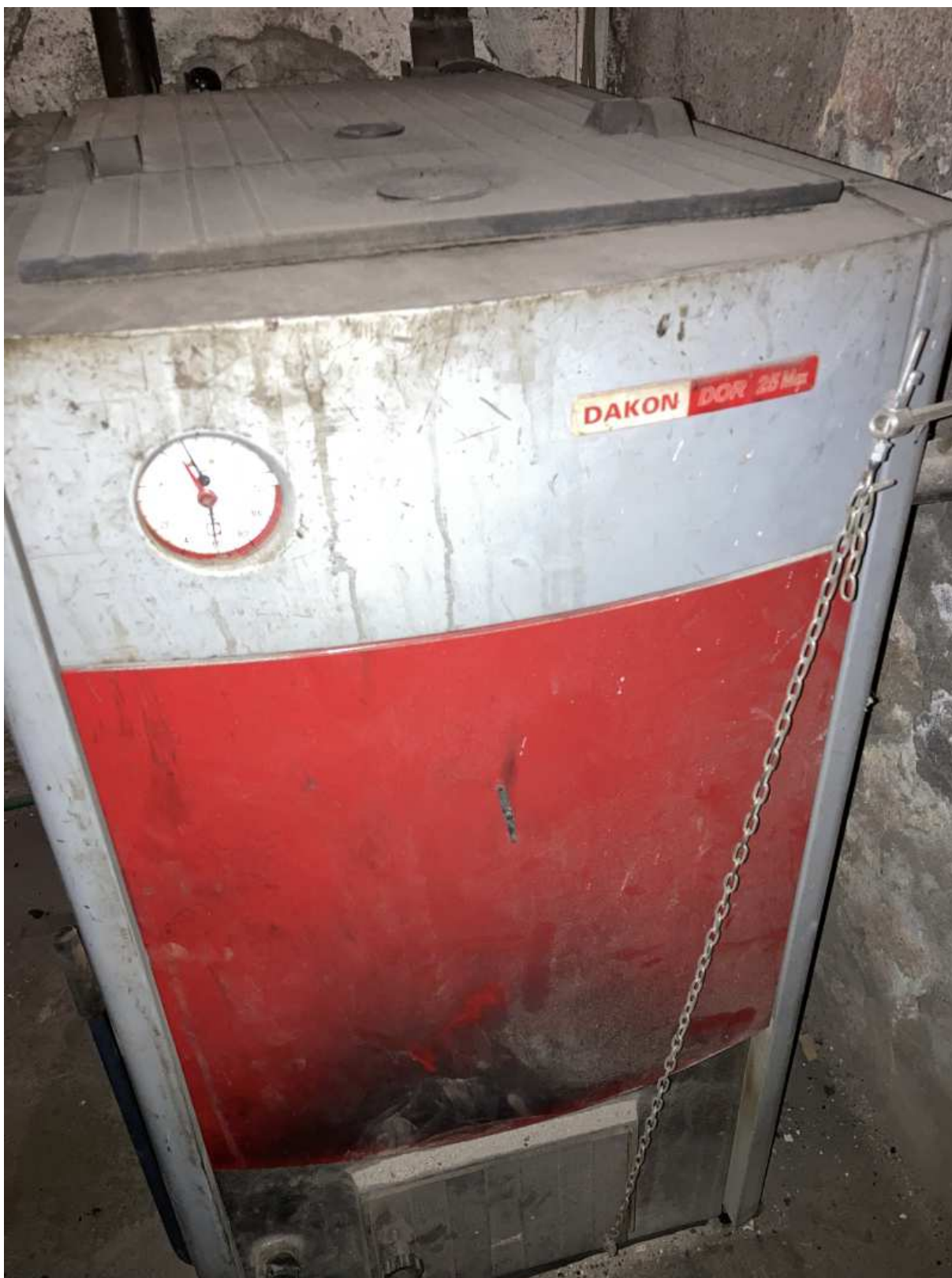
Obrázek 6 – pohled na kotel na uhlí
