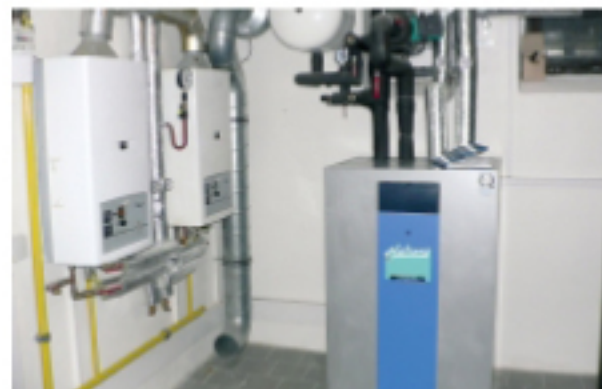
Kotelna s tepelným čerpadlem a plynovými kotli jako bivalentním zdrojem tepla. Foto: EkoWATT
