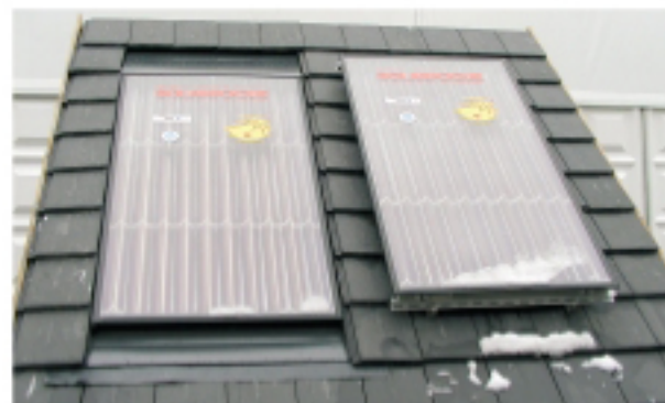
Kolektor integrovaný do střechy a uložený nad krytinou. Foto: EkoWATT
