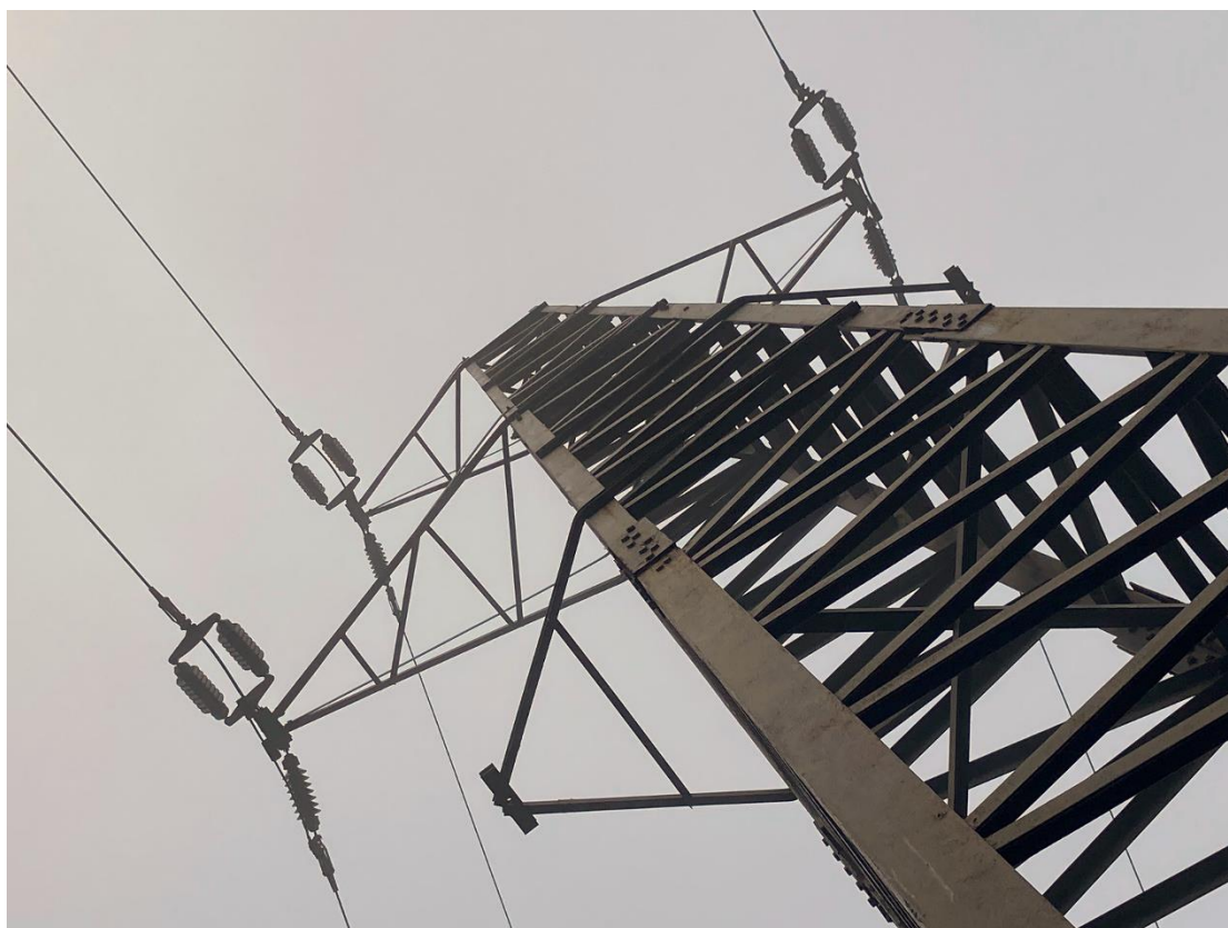
Obrázek I: Stožár vedení VN 35kV
