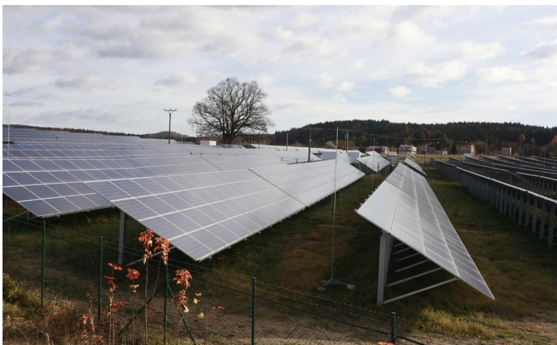
Obrázek 17: FVE f. ČEZ Obnovitelné zdroje [11]
