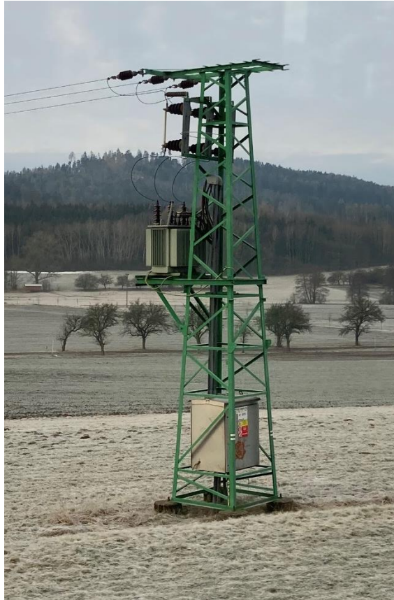
Obrázek 12: Příhradová trafostanice 35 kV
