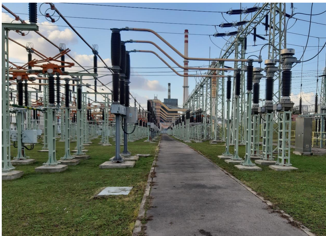
Obrázek 3: Rozvodna 220 kV, Praha Malešice
