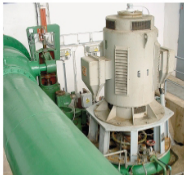
Turbína s generátorem na přivádění v úpravně pitné vody nahradí škrtící armatury. Foto: EkoWATT
